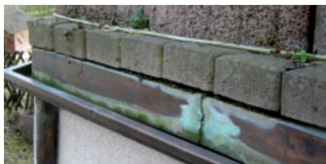
Střešní okapy ze zinku a mědi jsou náchylné ke vzniku defektů a nemají dlouhou životnost.
