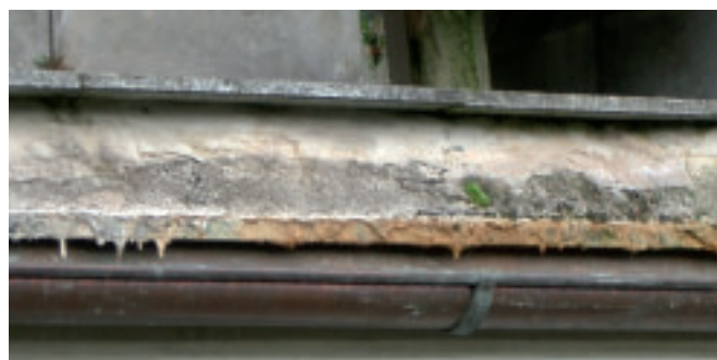
Výsledek nechráněných vrstev potěru: výkvěty poškozené okraje balkónu.
