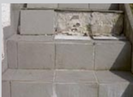
poškození vlhkostí z podkladu
