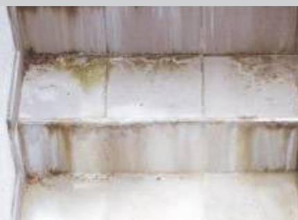
poškození vápennými výkvěty
