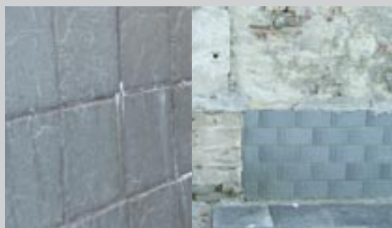
poškození vlhkostí z podkladu
