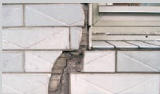
poškození vysokou teplotou
